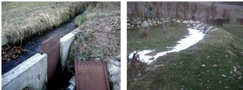
Abbildung 21. Der Muntaschinigbach bergseitig des Campingplatzes und das kleine Rückhaltebecken.
