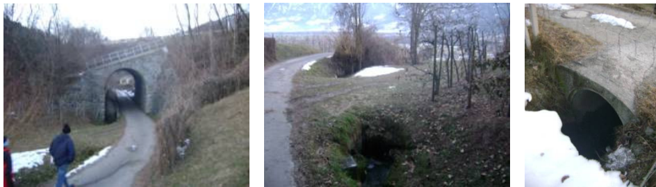
Figura 176. L'attraversamento ferroviario e l'intubazione del rio Tarces all'apice della conoie e particolare di una degli attraversamenti a tubo presenti nel tratto inferiore del rio.
