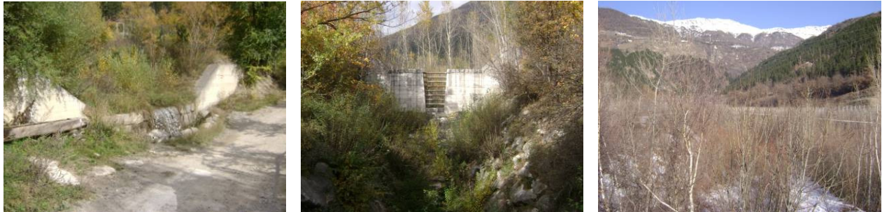
Figura 35. Sistemazioni nel tratto inferiore del rio Tanas, bacino di trattenuta e briglia filtrante.
