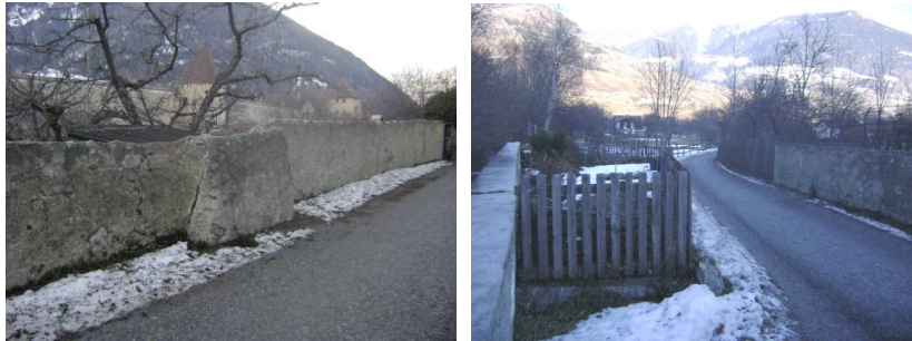
Figura 167. Il muro di protezione in destra orografica nel tratto urbano del Puni a Glorenza.
