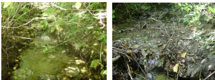
Figura 52. Alcune immagini dell'alveo del rio Plazut.
